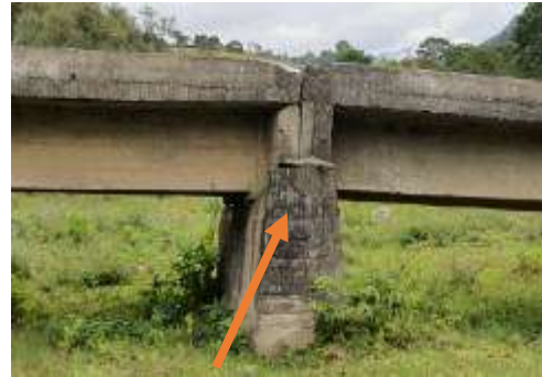
CA25 BASE DE LA VIGA RIOSTRA
